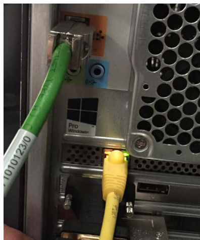
Rysunek 1-22: zielony – kabel Profinet do usługi VIPA (u góry po lewej) oraz żółty – połączenie internetowe (na dole po prawej)
