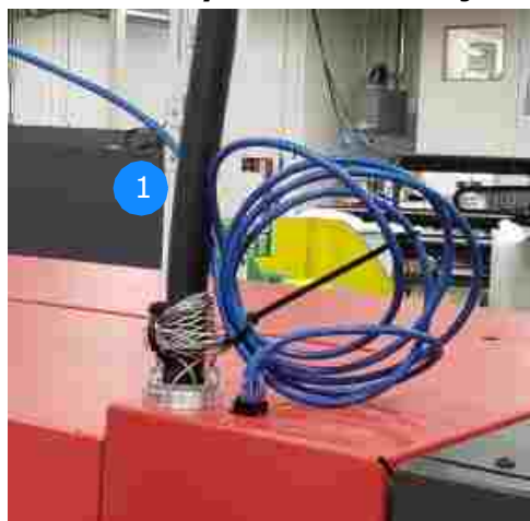
Rysunek 1-7: Przewód zasilania AC ze skrzynki rozdzielczej zakładu, góra, prawa strona, z tyłu
